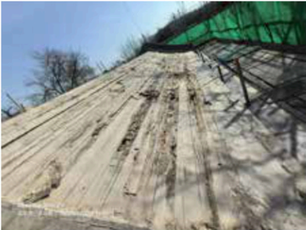
图七 中 2 号房屋面望板槽朽
