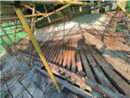
图八 四方亭屋面望板、椽子槽朽
