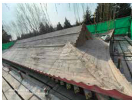
图一〇 过河亭南侧望板糟朽情况
