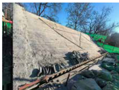
图一五 珠源寺南坡糟朽更为严重
