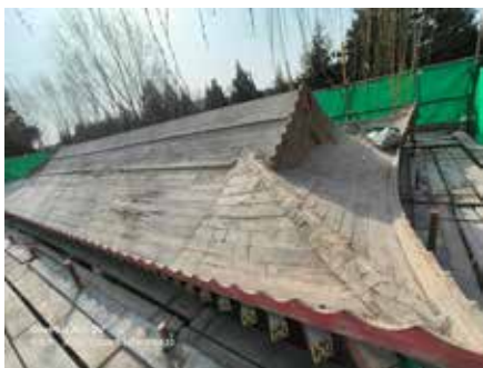
图一〇 过河亭南侧望板糟朽情况
