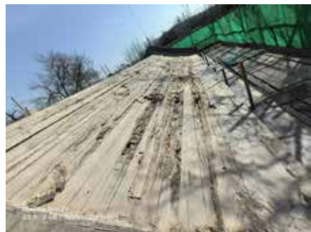
图七 中2号房屋面望板槽朽
