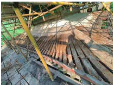
图八 四方亭屋面望板、椽子槽朽
