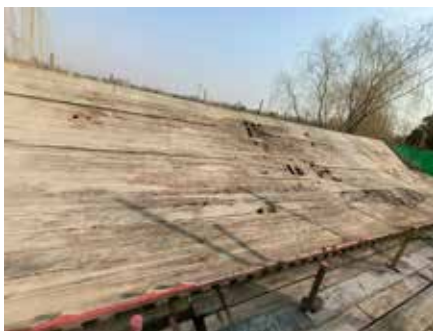
图一一 过河亭北侧望板糟朽情况
