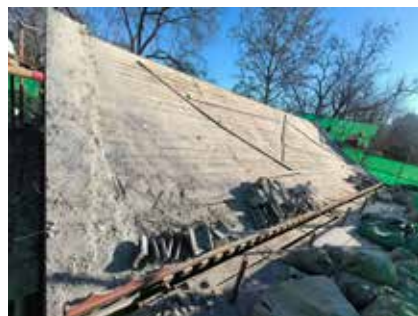
图一五 珠源寺南坡糟朽更为严重
