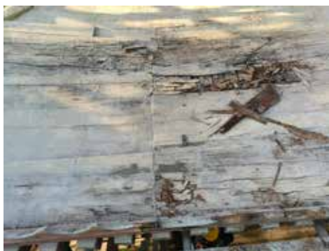
图五 濯月漪屋面望板槽朽
