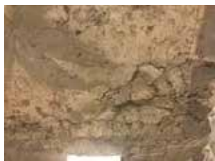
图四 多条纵横交错的细小裂隙及边缘地仗层脱落
