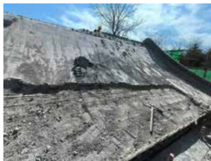
图一二 归云岫屋面拆除中可见灰背完好，望板糟朽严重
