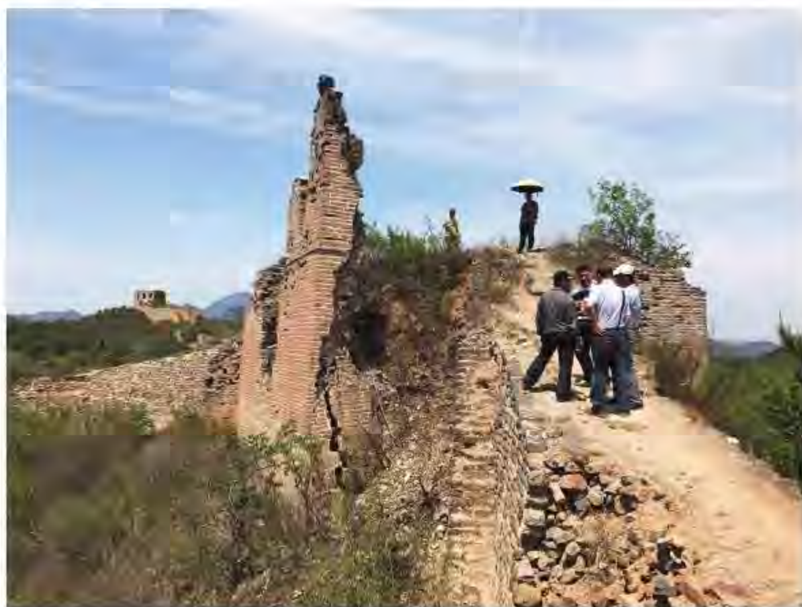
图二 专家现场勘察古北口长城险情
