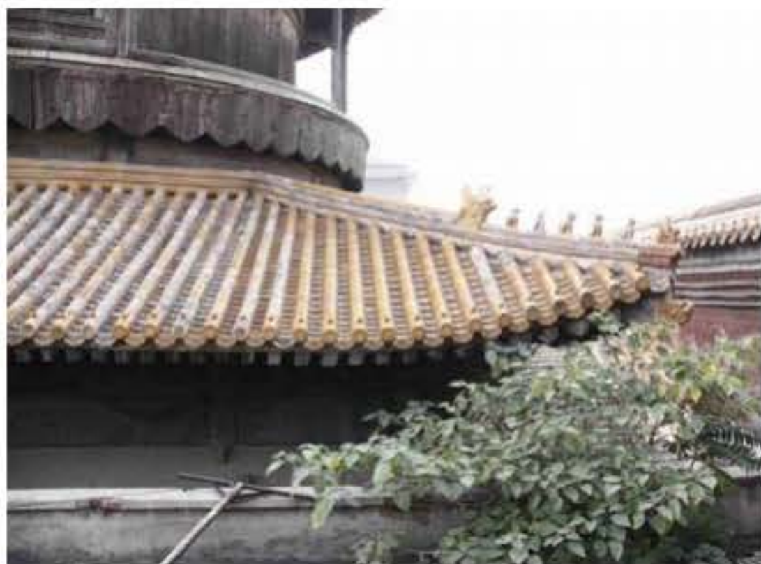
图五 一层角檐下沉及二层平座、挂檐外倾现状
