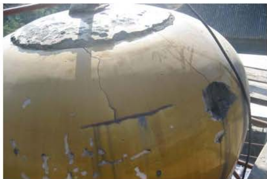
图七 宝顶（脱釉风化酥粉开裂，胎体损伤）
