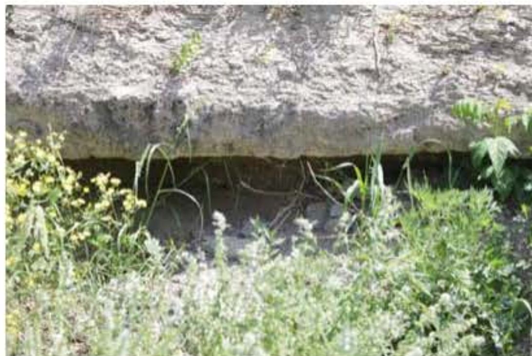
图一 东墙底部掏蚀
