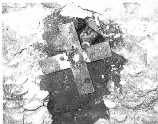
图版 8 锚杆深入柱体后留在表面的十字形钢板具有固定作用。
