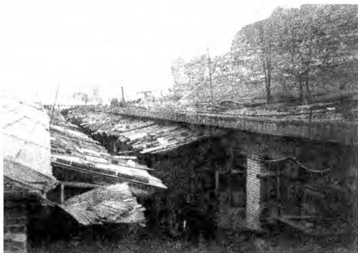
挖光夯土后,于城墙内建设的 违章建筑
