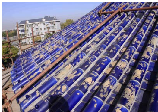
图八 二层蓝琉璃瓦现状（脱釉开裂，局部损伤）
