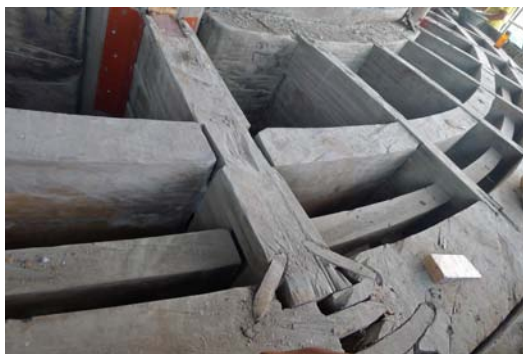
图四 二层平座斗拱楼板枋位移拔榫开裂现状
