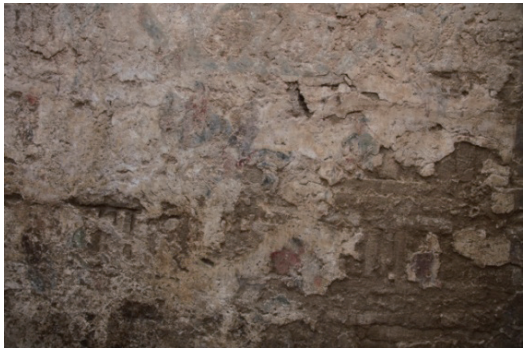
图九 西耳室西墙地仗层脱落
