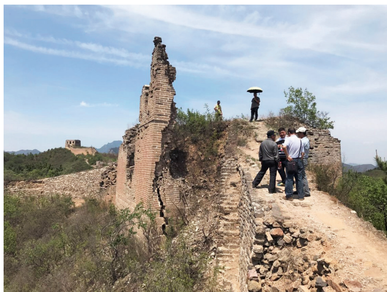
图二 专家现场勘察古北口长城险情
